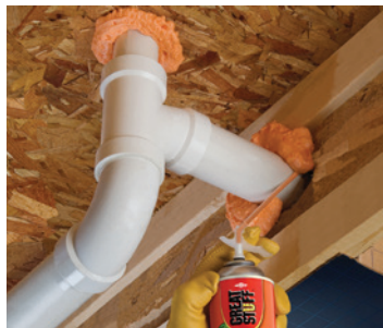
Pénétrations de tuyauterie
