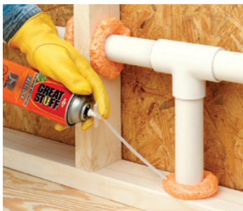
Pénétrations de tuyauterie
